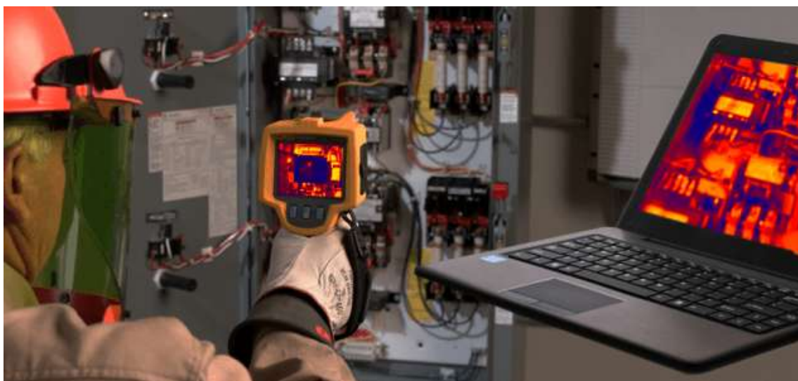
Рисунок 20. Пример проведения тепловизионного контроля электрошкафа
