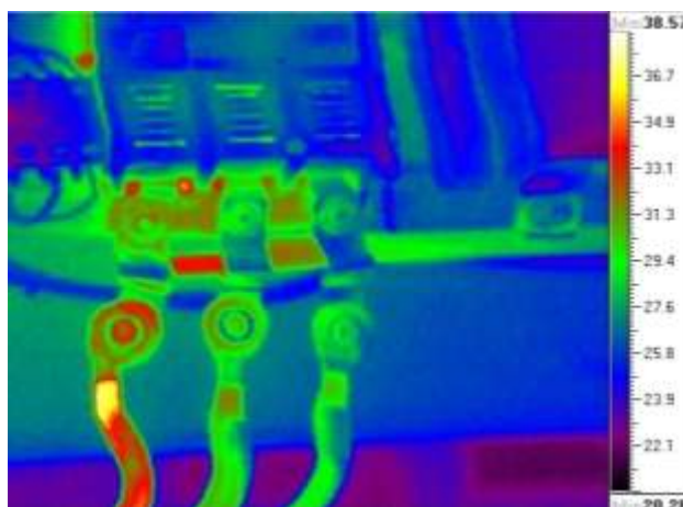
Рисунок 21. Пример термограммы контактных соединений с температурной шкалой
