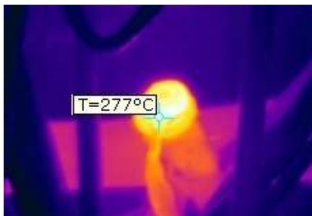
Рисунок 22. Пример обнаружения пожароопасного разогрева болтового контактного соединения
